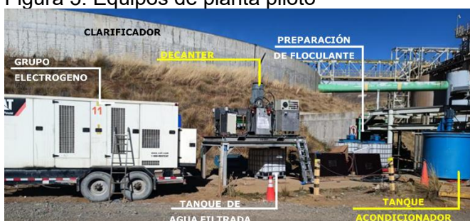
Figura 5: Equipos de planta piloto
